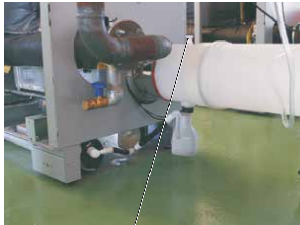
Измерительное отверстие на конденсатоотводчике
