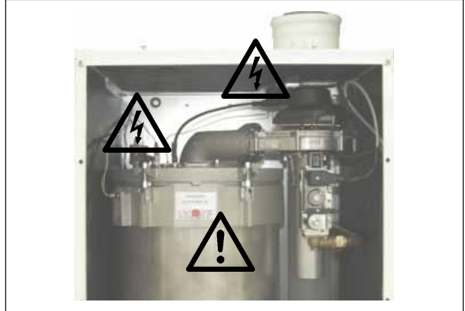
Εικόνα: Μετασχηματιστής ανάφλεξης, ηλεκτρόδιο ανάφλεξης υψηλής τάσης, εναλλάκτες θερμότητας Κίνδυνος από ηλεκτρική τάση, κίνδυνος λόγω ζεστών εξαρτημάτων
