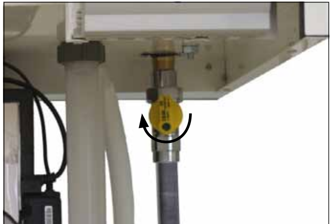
Resim: Gaz bağlantısı Kaçak gaz neticesinde, zehirlenme ve patlama tehlikesi
