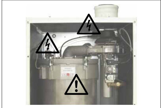
Figura: Transformador de ignición, electrodo de encendido, intercambiador de calor Peligro por tensión eléctrica, peligro de quemaduras por componentes muy calientes
