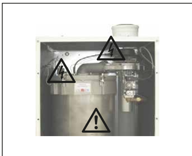
Рисунок: Запальный трансформатор, высоковольтный запальный электрод, теплообменник Опасность поражения электрическим током Опасность получения ожога от горячих деталей
